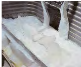
Ijsvorming op de buitenunit zonder bodemplaat verwarming
